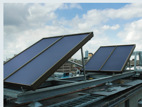
Κτίριο Ευρωπαϊκού κοινοβουλίου EU στις Βρυξελλές, Βέλγιο 28,80 m 2 συλλεκτών μεγάλης επιφάνειας FA της TiSUN, 3 ηλιακά δοχεία διαστρωμάτωσης με σφαιρικούς εναλλάκτες Pro-Clean 500 l, θέρμανση νερού.
